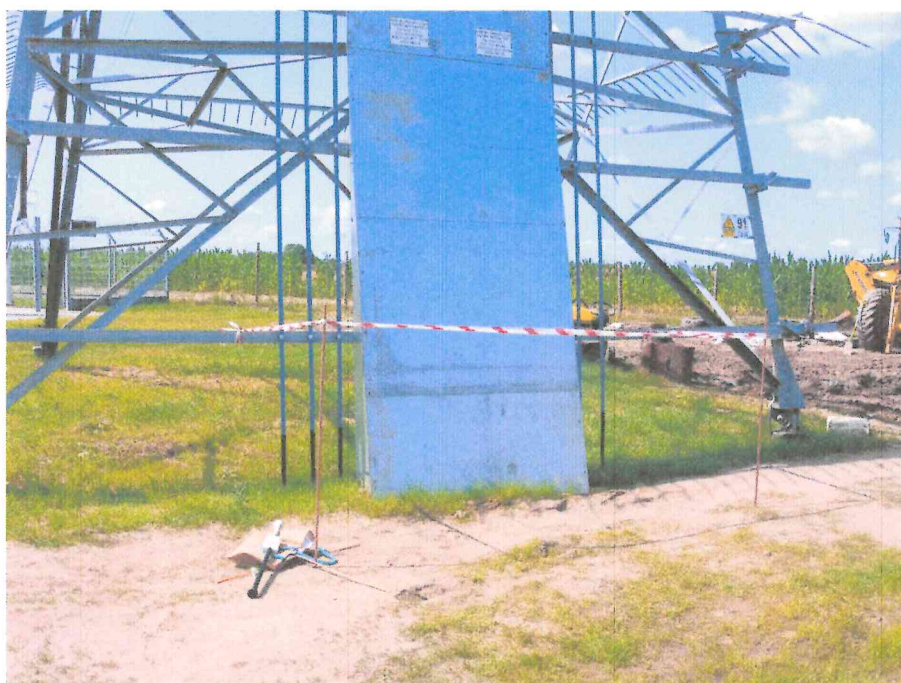
Fot. nr 6. Wyprowadzenie linii kablowych „Pniewy Tor 1” oraz „Pniewy Tor 2” na słup.
