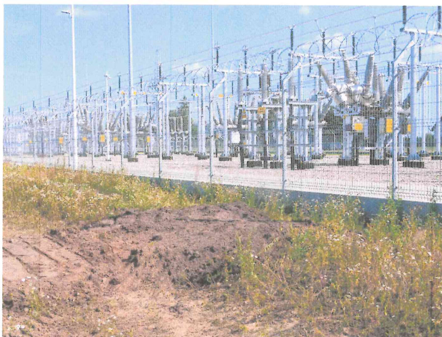
Fot. nr 2. Wyprowadzenie linii kablowej „Pniewy Tor 2” z terenu stacji.
