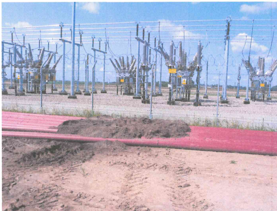
Fot. nr 3. Wyprowadzenie linii kablowej „Samolęż” z terenu stacji.
