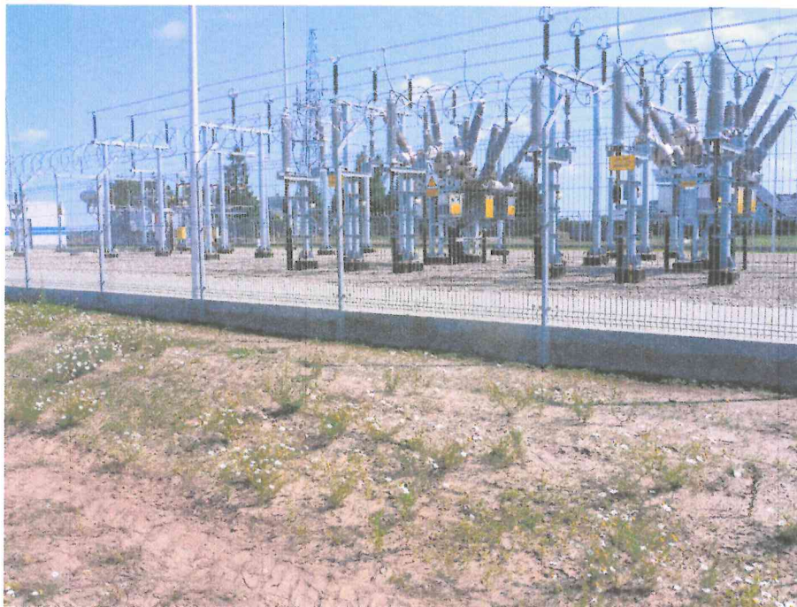
Fot. nr 1. Wyprowadzenia linii kablowych „Pniewy Tor 1” oraz „Drawski Młyn” z terenu stacji.
