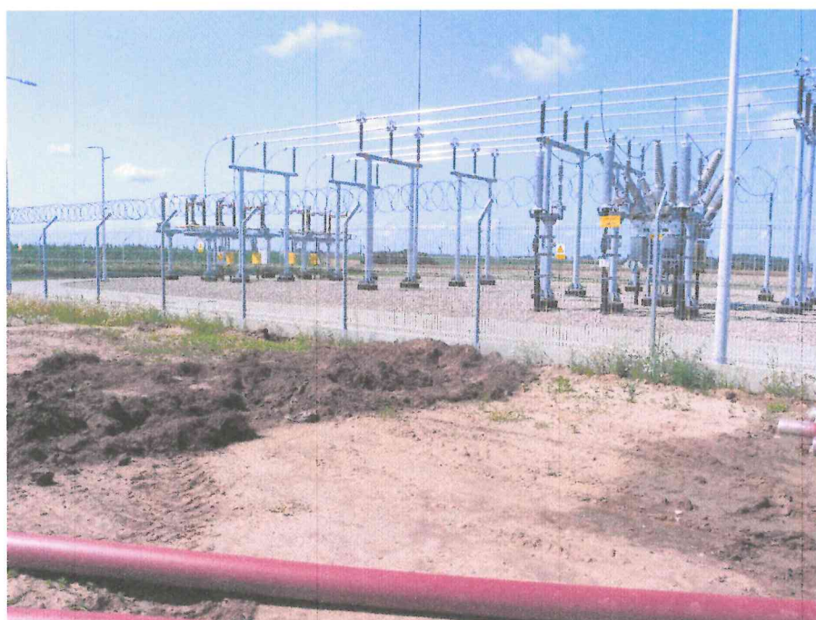
Fot. nr 4. Wyprowadzenie linii kablowej „Szamotoły” z terenu stacji.
