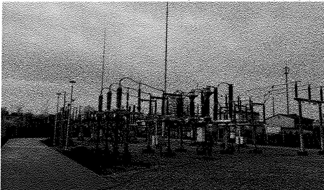
Zdjęcie nr 1. Rozdzielnia sieciowa RS 110 kV Samolęż– widok fragmentu obiektu.
