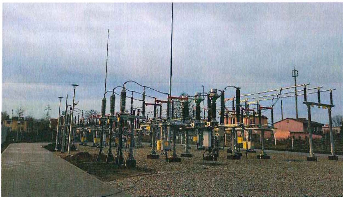
Zdjęcie nr 1. Rozdzielnia sieciowa RS 110 kV Samoleź– widok fragmentu obiektu.
