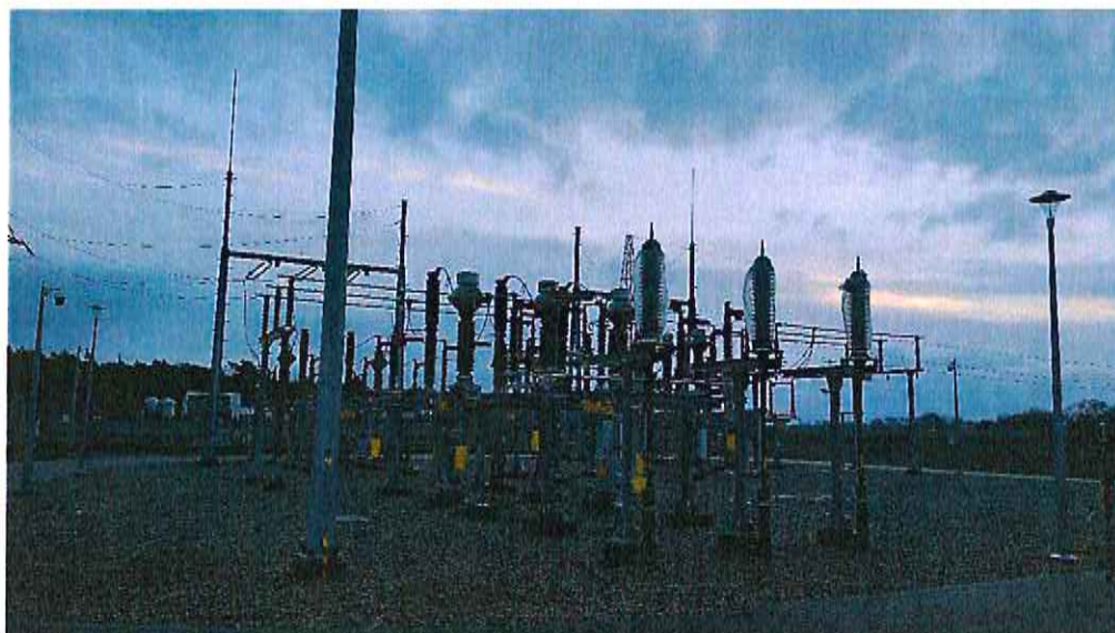
Zdjęcie nr 2. Rozdzielnia sieciowa 110 kV RS Pamiątkowo – widok fragmentu obiektu
