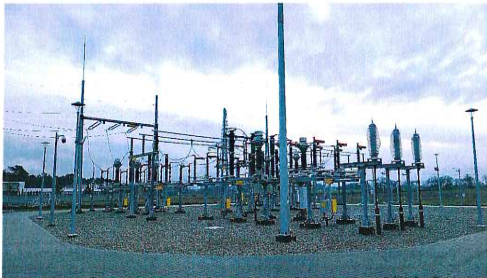
Zdjęcie nr 1. Rozdzielnia sieciowa 110 kV RS Pamiątkowo – widok fragmentu obiektu
