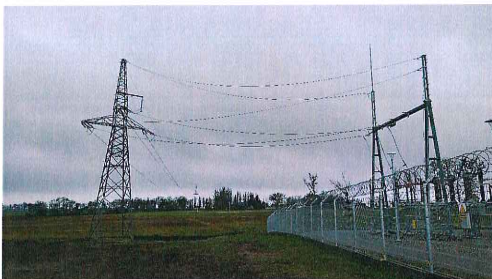
Zdjęcie nr 2. LWN 110 kV relacji RS Pamiątkowo – GPZ Tarnowo Podgórne – widok fragmentu obiektu
